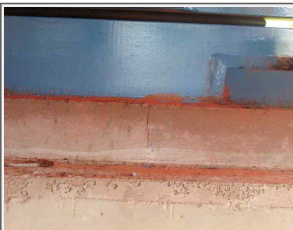
화남교(영천) P2, 횡방향이동단 무수축물탈 균열(0.3mm)
