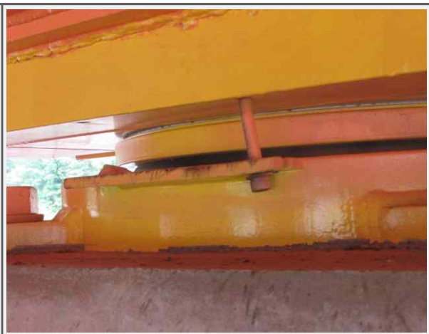
화남교(영천) P2, 횡방향이동단 임시고정볼트 미제거
