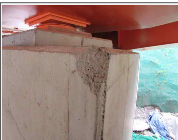
화남교(영천) P3 코핑부 콘크리트 파손
