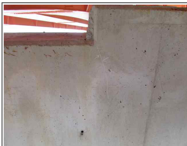
화남교(상주) P2 코핑부 균열 (0.3mm)
