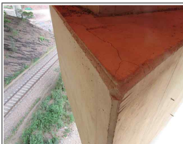
화남교(영천) P1 코핑부 콘크리트 파손
