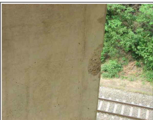
화남교(상주) P1 코핑부 콘크리트 파손
