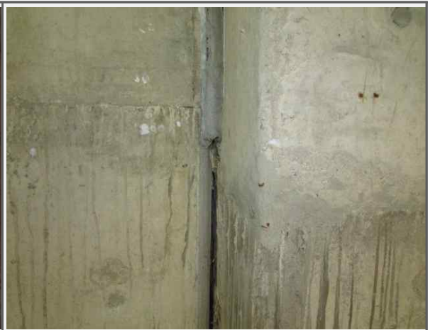
화남교(상주) A1 측면 실런트 파손
